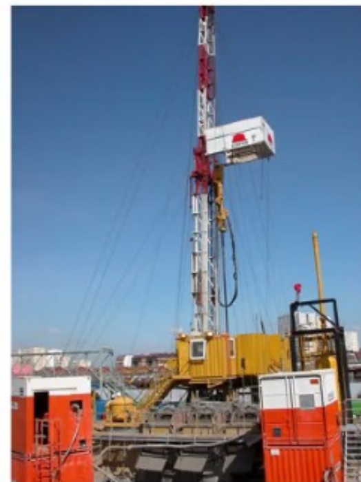
Forage pour la mise en place d'un réseau de chaleur à Paris, porte d'Aubervilliers, en 2009 (© BRGM)
